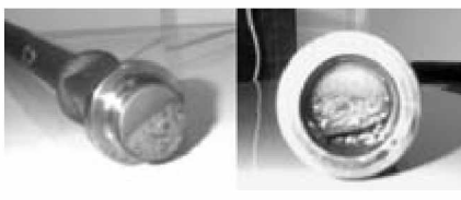
Figura 5: Falla en una Unión 7/8"
